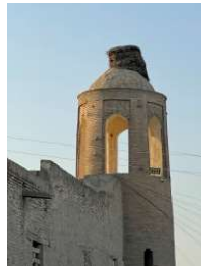
Илл.10. Сохранившееся гнездо ауста на восточной башне-гульдаста медресе Абдлазиз-хана. Фото автора 2020 г.
